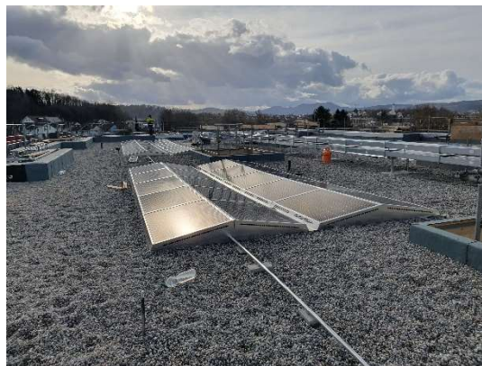
Bewölktetes Wetter im Sommer 2021 PV-Anlage Schulhaus Brühl 3
