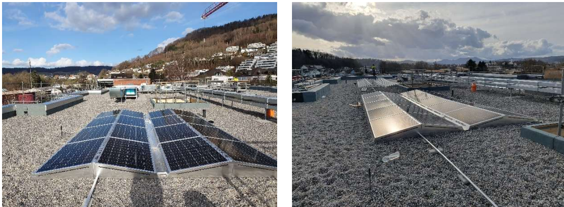
PV-Anlage Schulhaus Brühl 3
